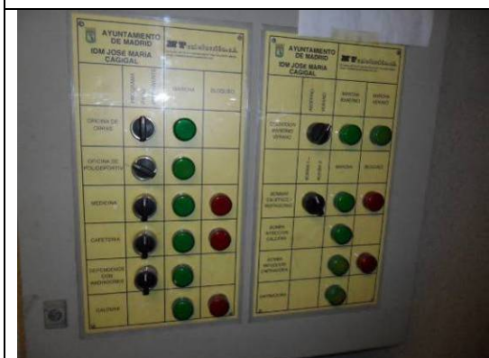
Cuadro eléctrico sala calderas Oficinas
