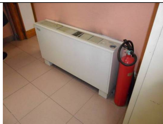
Fan coil Oficinas
