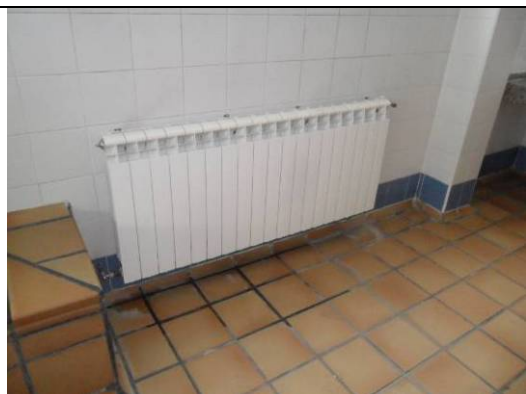
Radiador Vestuarios 4ª planta
