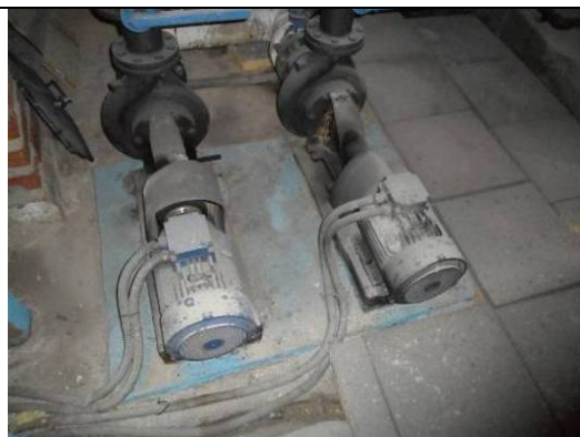
Bombas piscina infantil
