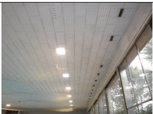
Iluminación Piscina Cubierta
