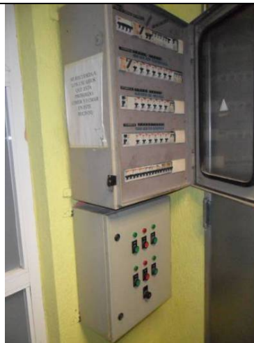
Cuadro eléctrico. Pabellón
