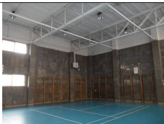
Iluminación Bádminon. 5ª planta.
