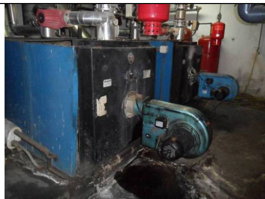
Caldera Edificio Vestuarios
