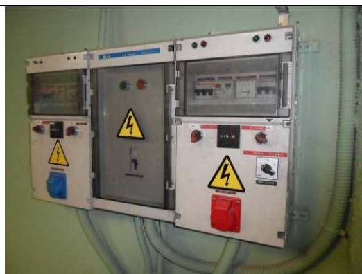
Cuadro bombas depuración Piscina Cubierta
