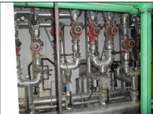
Bombas calefacción y ACS
