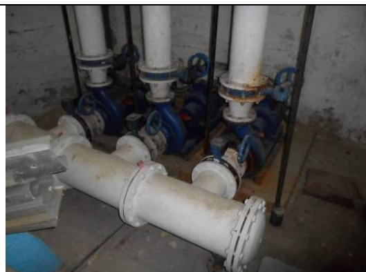
Bombas piscina 50 m
