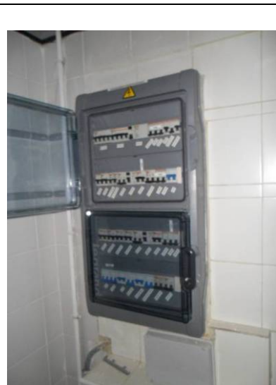
Cuadro eléctrico vestuarios. Piscina Verano
