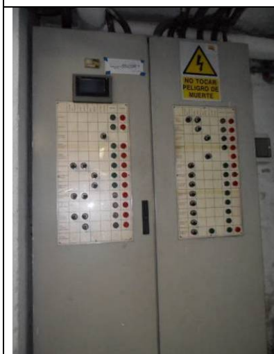
Cuadro eléctrico sala calderas. Edificio Pabellón y Piscina
