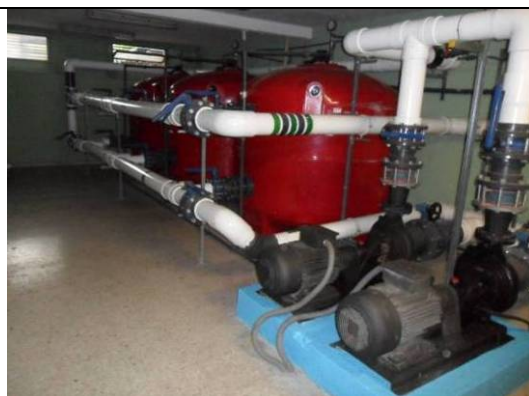
Bombas Piscina Cubierta
