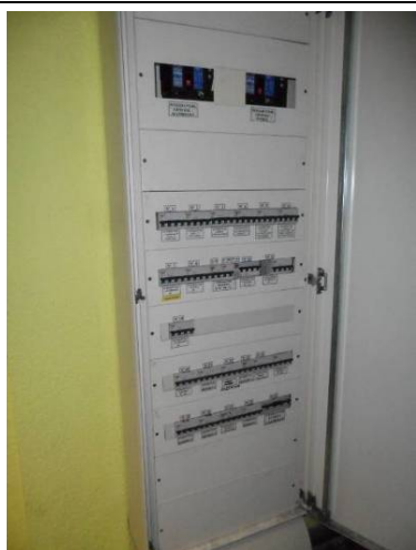
Cuadro eléctrico general. Edificio Pabellón, Piscina Cubierta, Vestuarios Gimnasios, Salas Reuniones y Saunas
