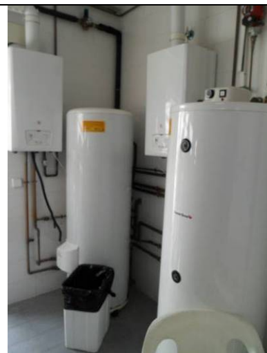
Calderas Vestuarios 3 y 4
