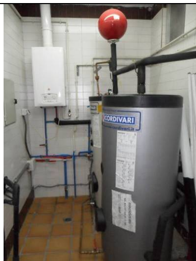
Calderas Vestuarios 1 y 2
