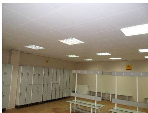
Iluminación vestuarios Pabellón.
