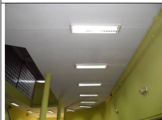
Iluminación hall de entrada
