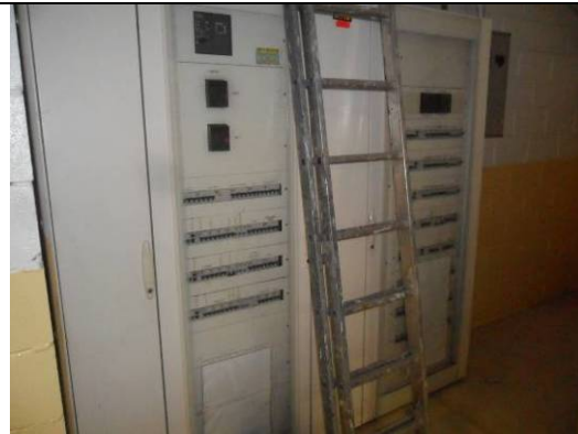
Cuadro Eléctrico General
