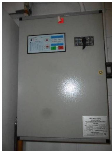
Batería de Condensadores
