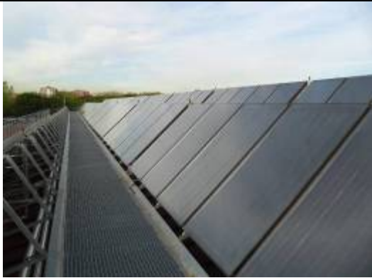
Instalación solar térmica
