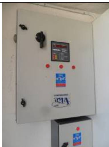
Batería de condensadores Campo de Fútbol
