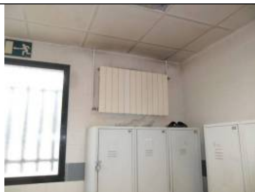
Radiadores vestuario personal
