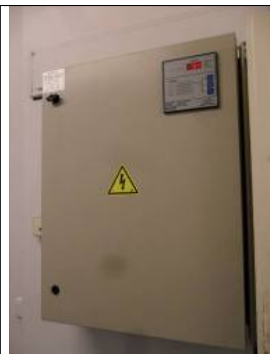
Batería de condensadores Piscina 50 m
