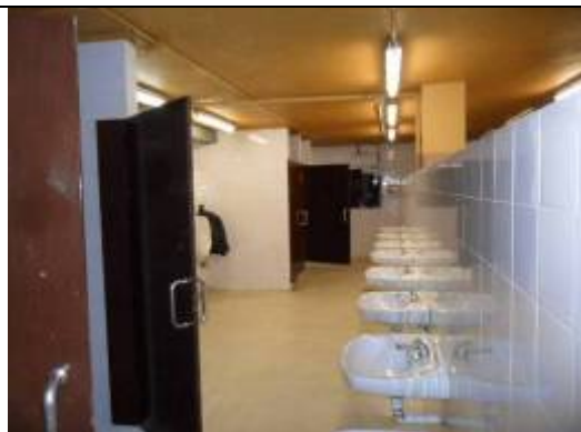
Iluminación aseo pabellón polideportivo 1
