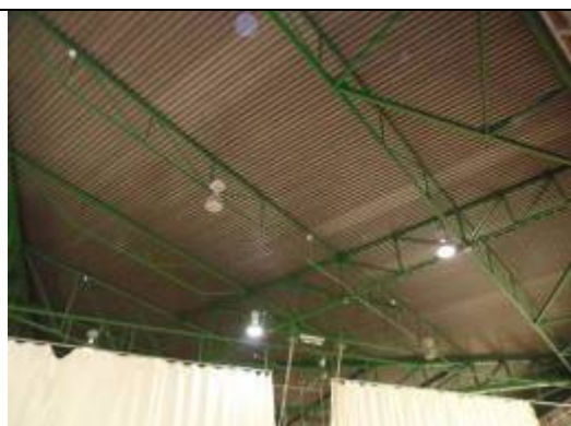
Iluminación pabellón polideportivo 2
