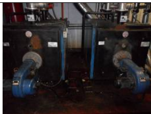
Sala Calderas Piscina 25 m.
