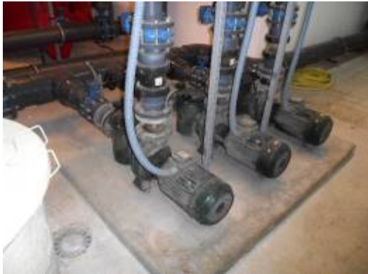
Bombas depuración Piscina 50 m.
