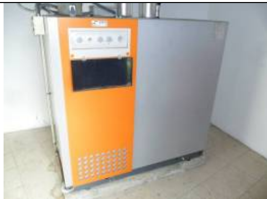
Caldera Pabellón Deportivo 2
