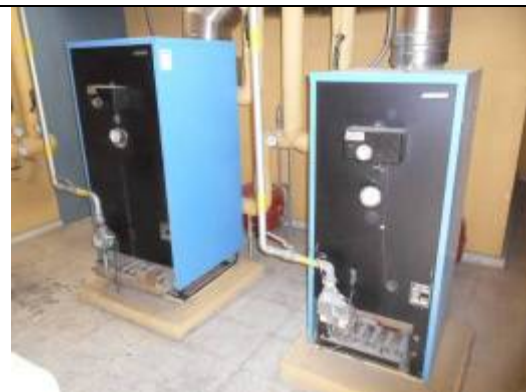
Sala de Calderas Campo de Fútbol
