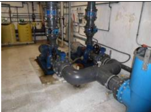
Bombas depuración Piscina 25 m.
