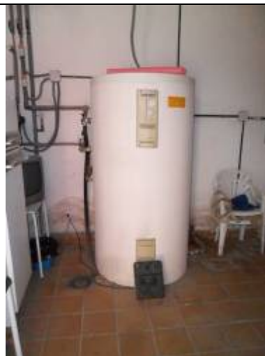
Acumulador Caldera Edificio Vestuario Personal
