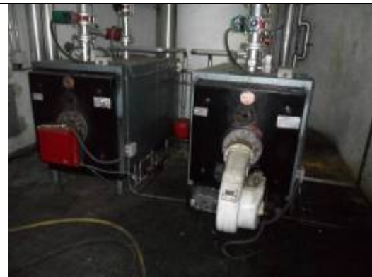
Sala Calderas Pabellón Deportivo 1
