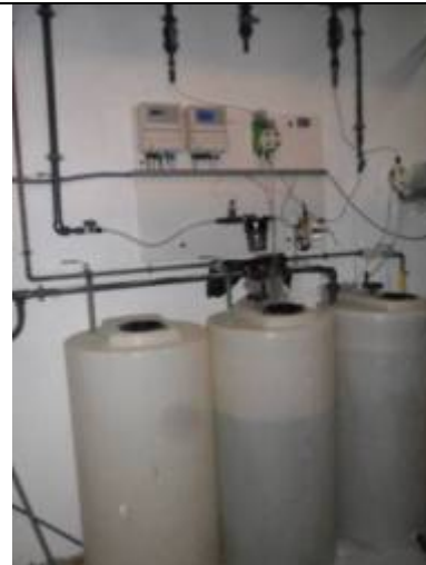
Tratamiento de aguas Piscina 50 m.
