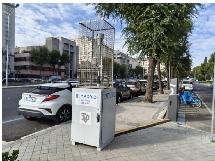
Armario portable instalado en Nuevos Ministerios
