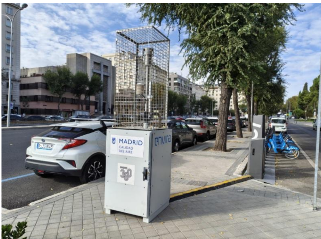
Imagen 1. Cabina móvil instalada en Nuevos Ministerios
