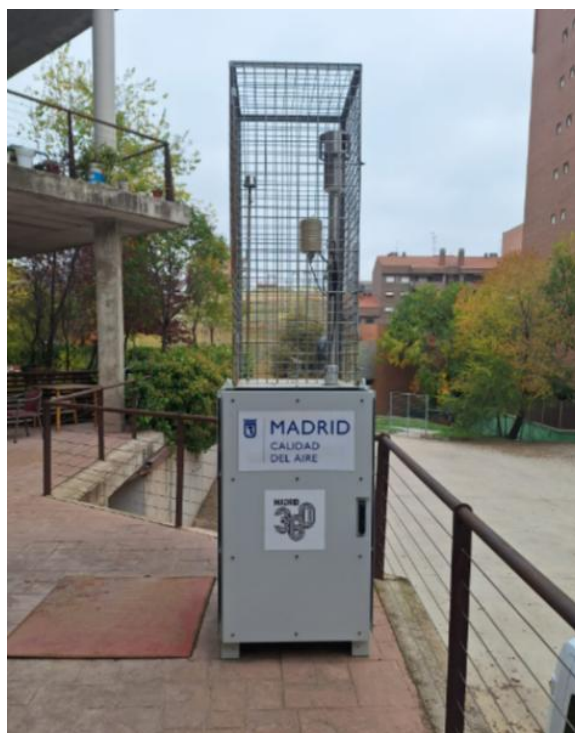
Imagen 1. Cabina portable instalada en Centro Municipal de Mayores Carmen Laforet.
